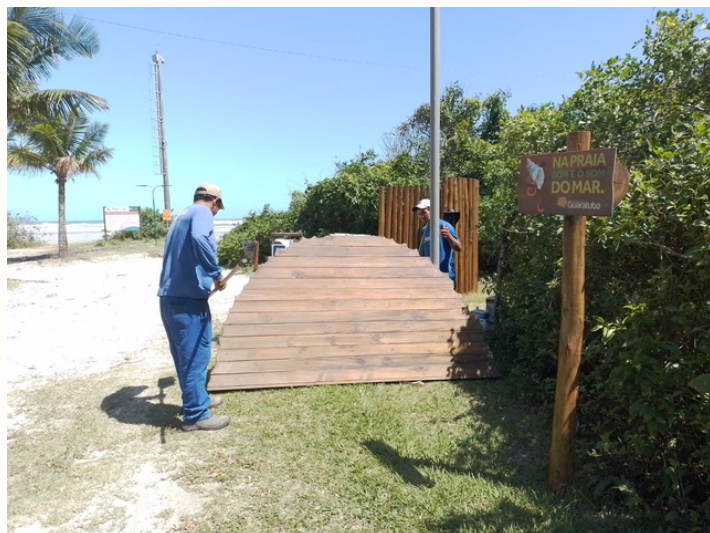
MANUTENÇÃO- DUCHA PRAIA
